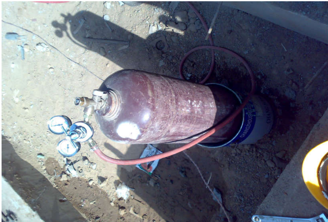
丙烷气瓶及减压器
